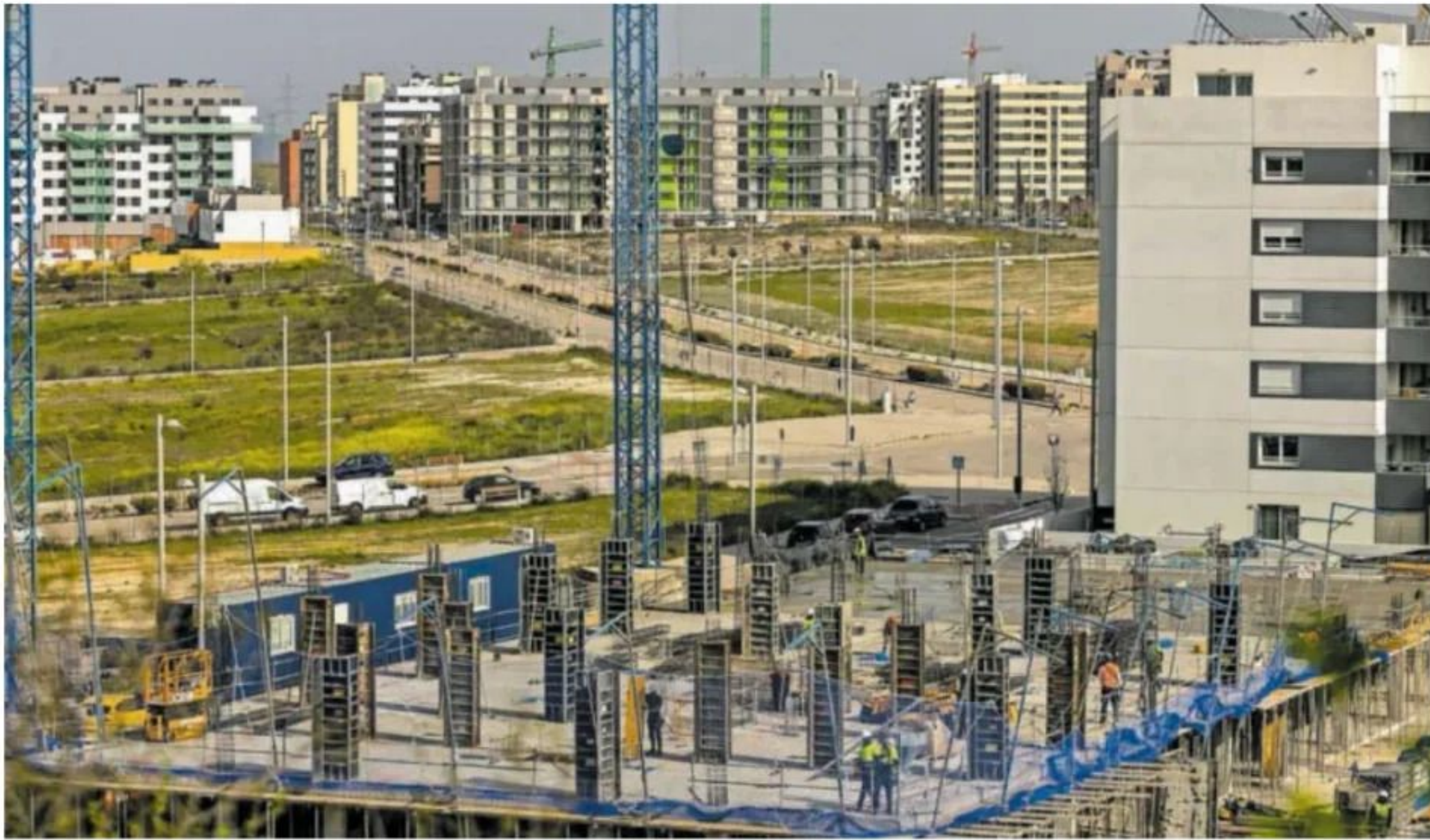
Construcción de viviendas en El Cañaveral (Madrid), el jueves pasado. SAMUEL SÁNCHEZ
